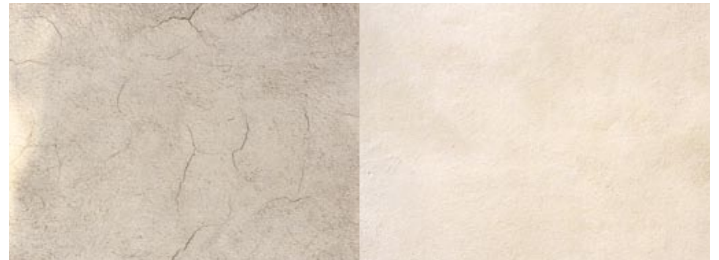
Sprickor/krackelering före och efter användning av mellanstrykning
